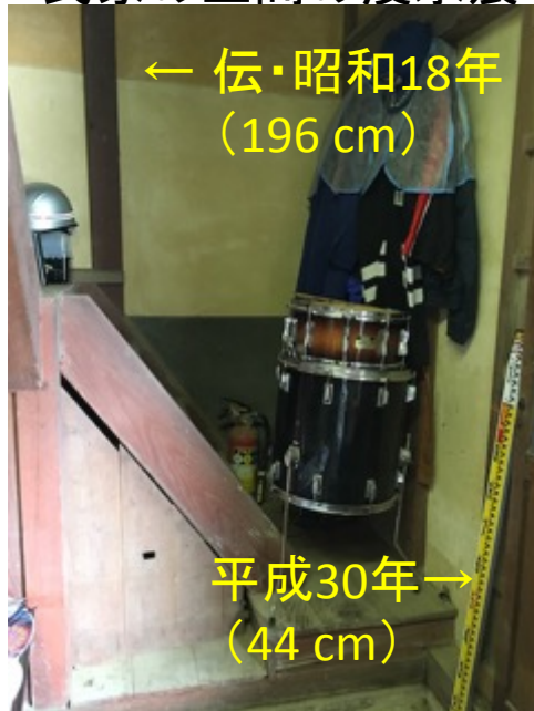
民家の土間の浸水痕
