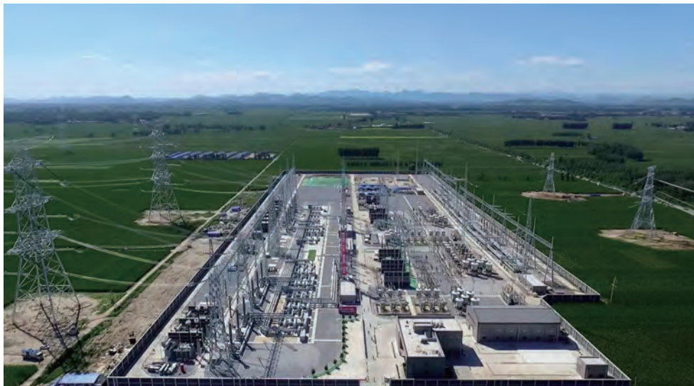
图 22 蒙西~天津南 1000 千伏交流输变电工程
