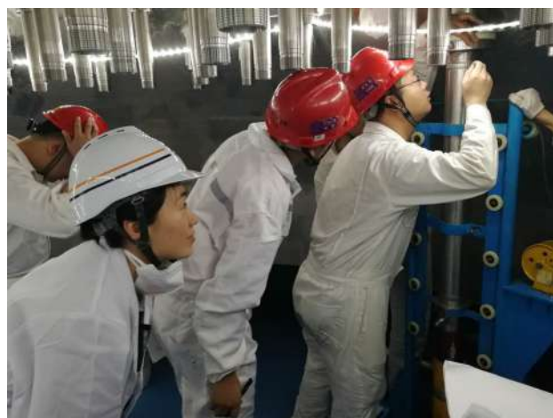
图 6 监督员见证红沿河核电厂 5 号机组控制棒驱动机构密封焊水压试验后渗透检验
