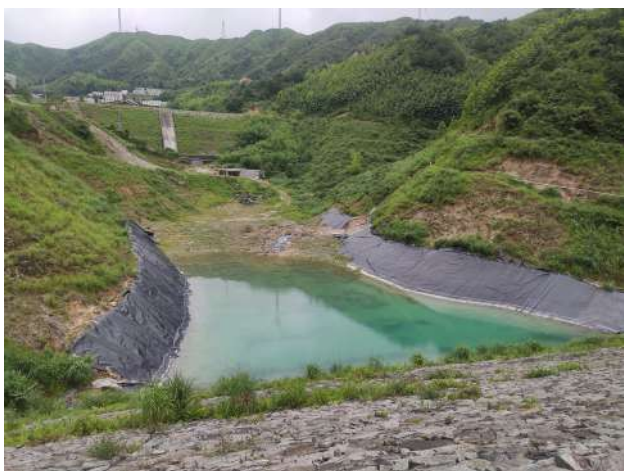
图 23 尾渣库防渗设施
