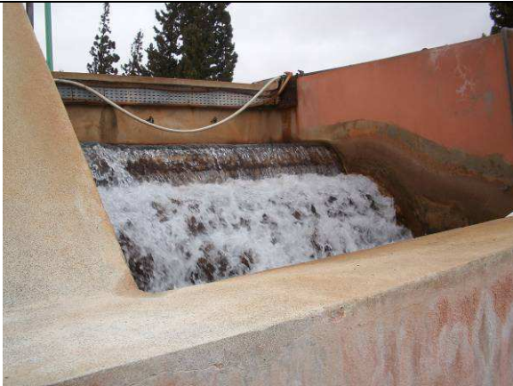
Cascade d'aération et floculation
