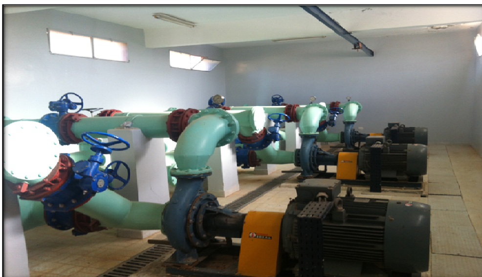
Figure 1 : Local et groupe de la station de pompage SP0
