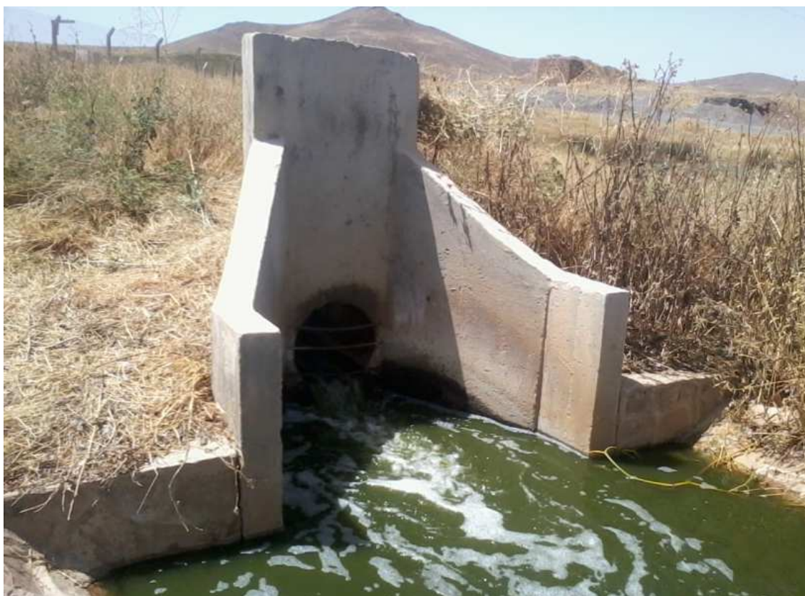
Vues sur l'ouvrage de rejet des eaux épurées
