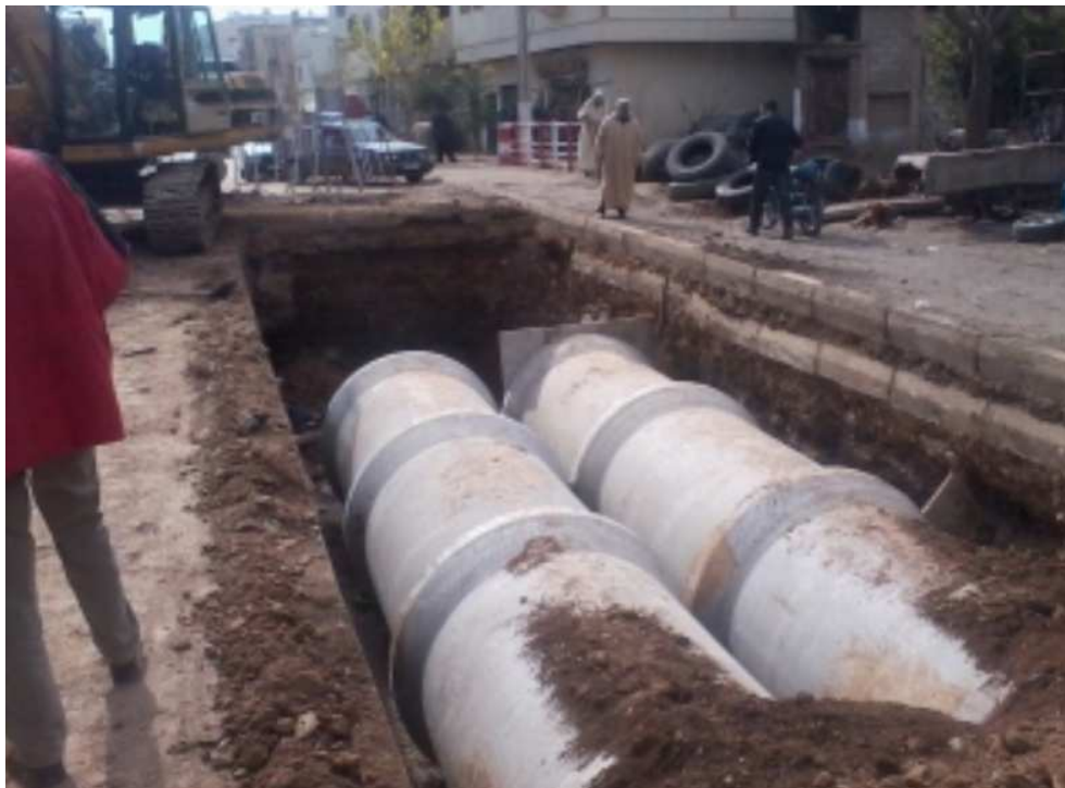
Figure 24 : Exemple d'une tranchée ouverte non sécurisée en zone urbaine
