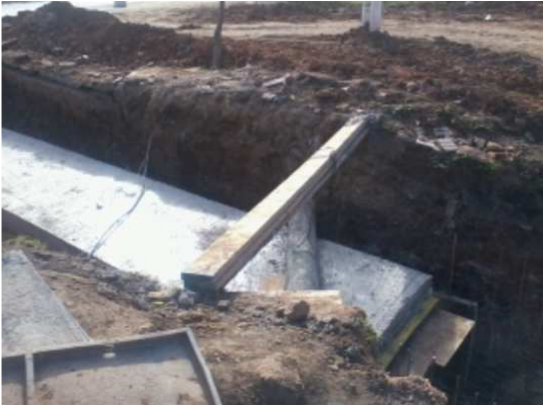
Figure 23 : Exemple d'un passage instable et non sécurisé au dessus d'un dalot
