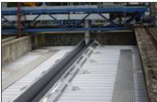
Photo 1: Exemple de couverture d'ouvrages de prétraitement
