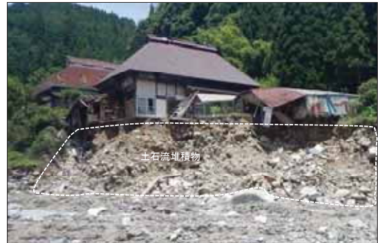
乙石川2k500付近の家屋下部侵食面に見る過去の土石流堆積物
