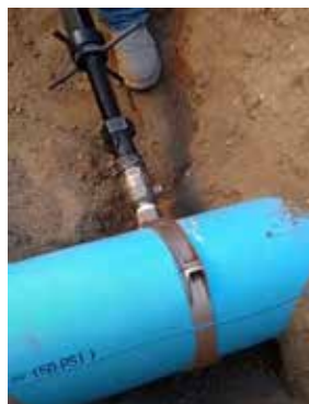
Silleta de derivación con llave de paso de servicio
