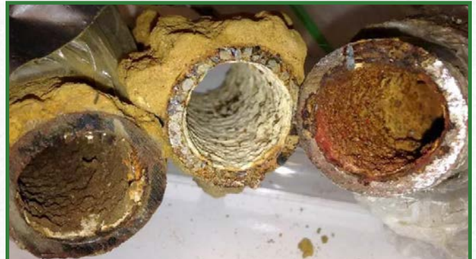
FIGURA A.25 : MUESTRAS DE TUBERÍAS CORROÍDAS DE HIERRO DE FLINT, MICHIGAN
