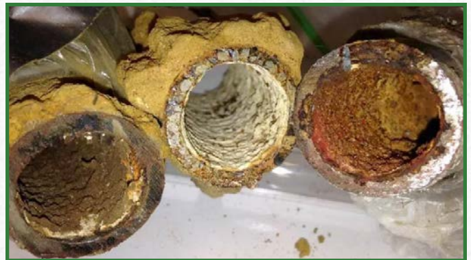
FIGURE A.25 : ÉCHANTILLONS DE TUYAUX EN FONTE CORRODÉS EN PROVENANCE DE FLINT, AU MICHIGAN
