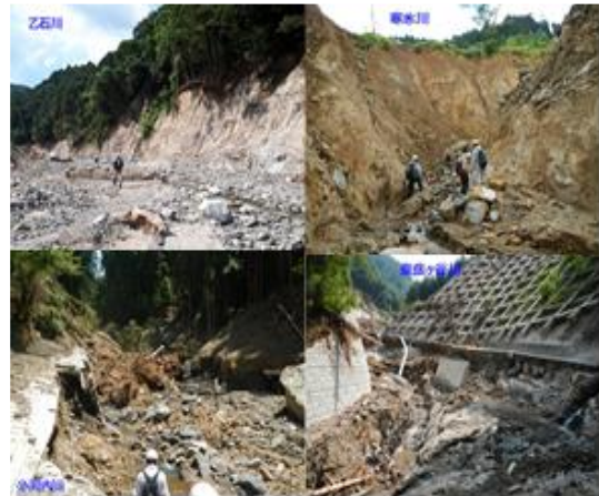
写真-8 河床洗掘・河岸侵食（その1）
