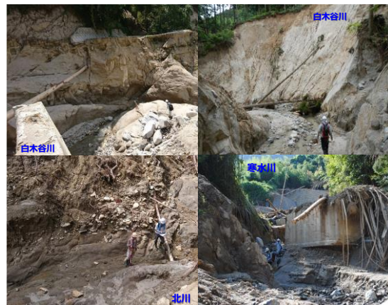
写真-9 河床洗掘・河岸侵食（その2）
