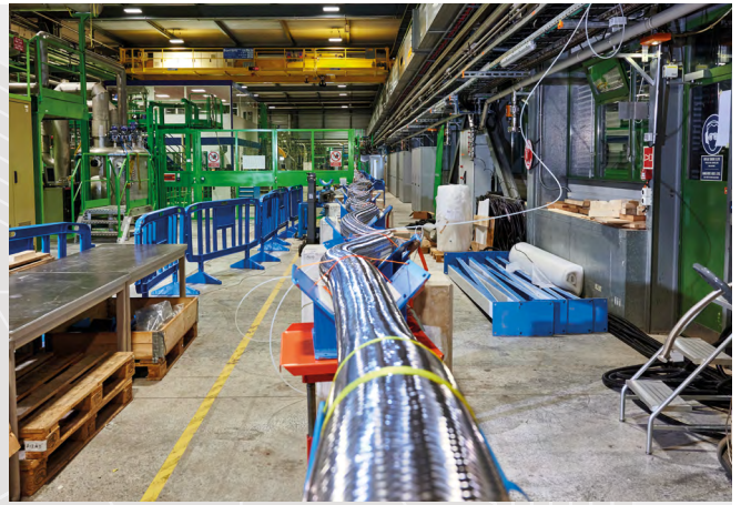
Avec 54 000 ampères transportés sur 60 mètres de long, cette ligne de transmission électrique destinée au LHC à haute luminosité est la plus puissante jamais construite. (CERN-PHOTO-202002-043-5)
