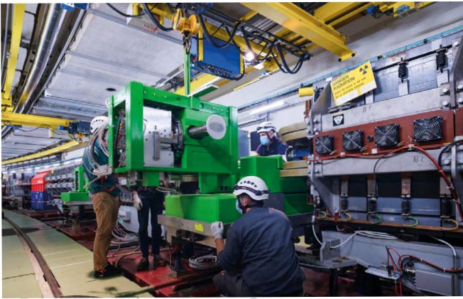
Les deux nouveaux absorbeurs de faisceaux internes du PS, encastrés dans une structure blindée en acier et béton (en vert), ont été installés dans l'accélérateur au mois de juin. (CERN-HOMEWEB-PHO-2020-094-1)
