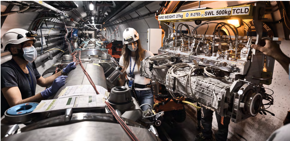
Un collimateur de type TCLD en cours d'installation au point 7 du LHC. (CERN-PHOTO-202007-102-1)
