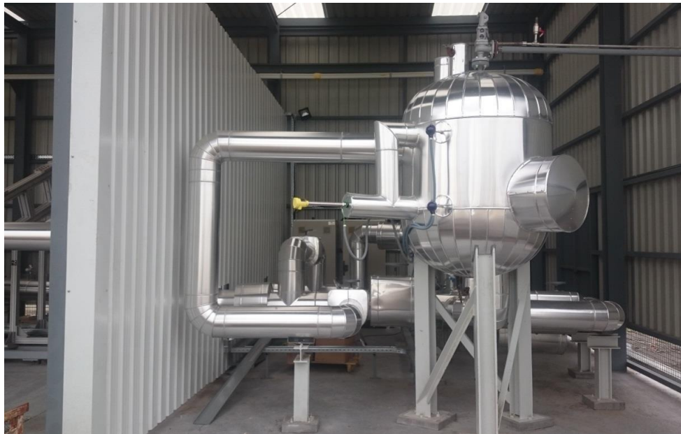
Figura 38. Foto del balance de planta de la instalación, en 2016 [Cortesía de DLR].
