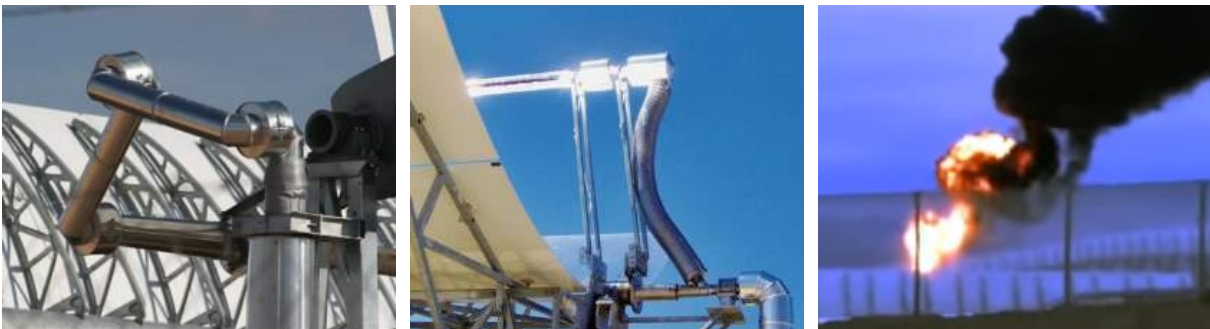
Figura 3. Tipos de REPA y consecuencias de su fallo. Izquierda: REPA de junta de bolas. Centro: REPA de manguera flexible. Derecha: incendio provocado por el fallo de un REPA en la planta de Andasol [7].
