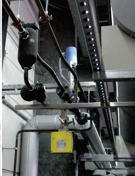
Bild 4: Einspeisung in Dampfschiene
