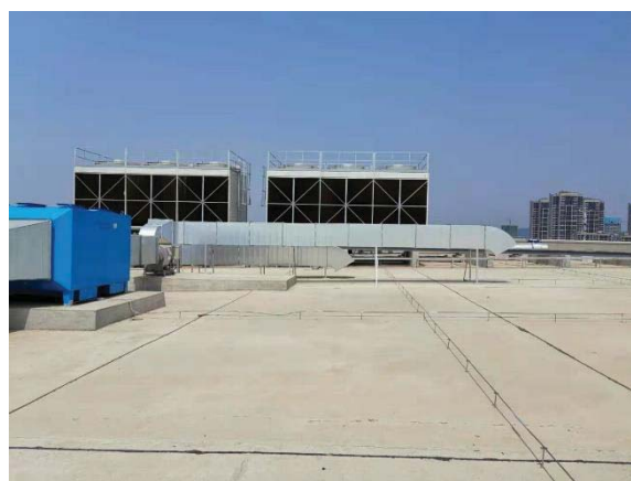
活性炭处理装置及排气筒（6#~9#一致）
