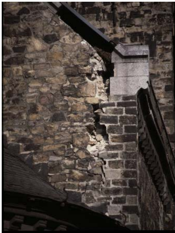
Figure 2.4.3. Fissuration à l'angle de deux murs: église St Gilles (Liège, 1983)
