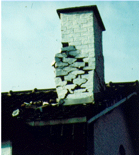
Figure 2.4.16. Cheminée de bonne qualité endommagée (Liège, 1983)
