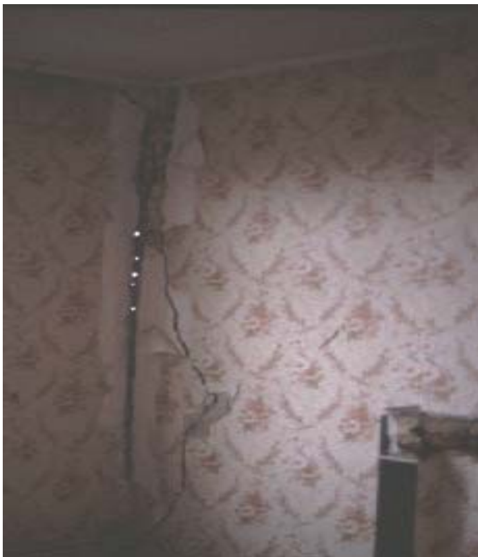
Figure 2.4.5. Fissuration à l'angle de murs (Liège, 1983)
