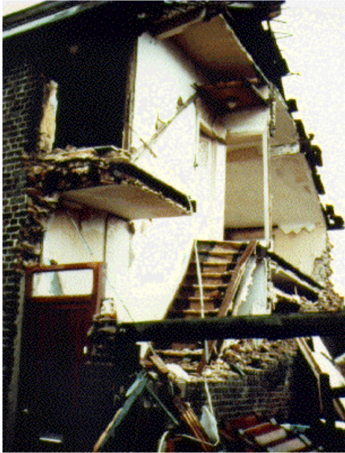
Figure 2.4.4. Effondrement de façade (Liège, 1983)
