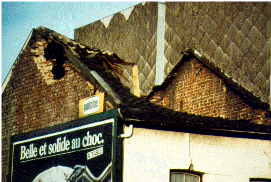
Figure 2.4.9. Effondrement de toiture (Liège, 1983)
