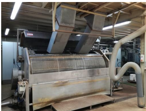
Figura 15- Equipamento de Lavação.
