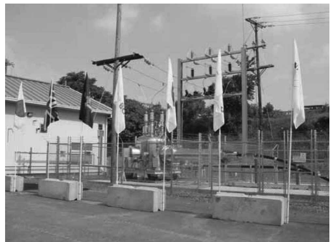
写真6 超電導ケーブル試験サイト (NY州、Albany)
