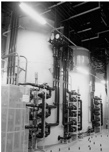
写真4 瞬低抑制用3MWシステム（電解液タンク）
