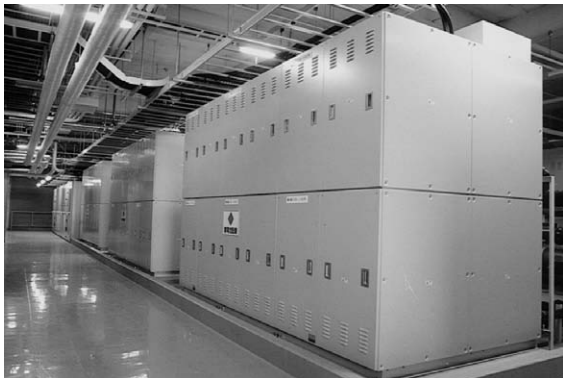
写真3 瞬低抑制用3MWシステム（電池盤）
