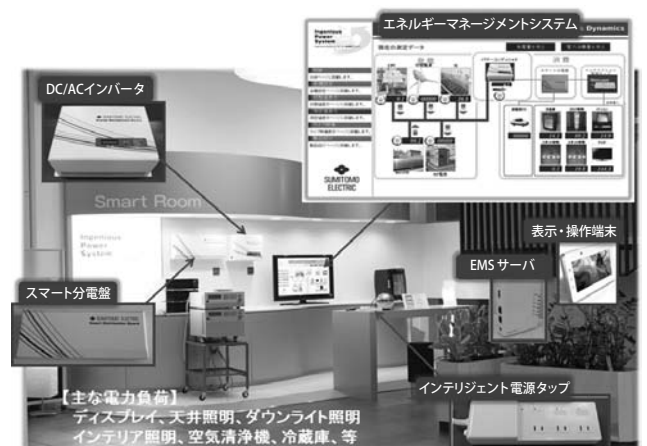
写真1 マイクロスマートグリッド実証システムの管理スペース
