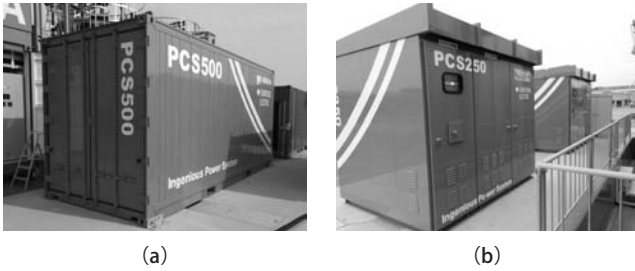
写真5 パワーコンディショナー (a) 500 kW パワーコンディショナー (株)明電舎 製 (b) 250 kW パワーコンディショナー 日新電機(株) 製
