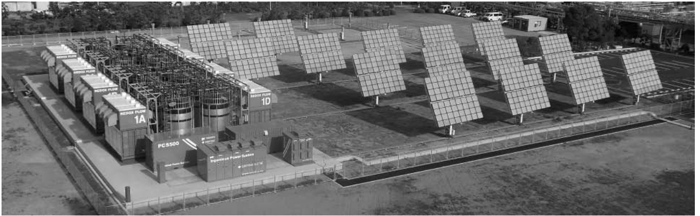
写真2 大規模蓄発電システムの全体像（住友電気工業(株)横浜製作所内）
