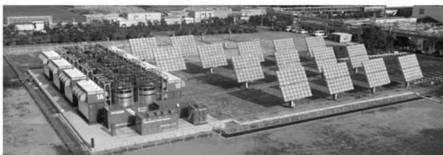
写真1 メガワット級蓄発電実証システム外観
