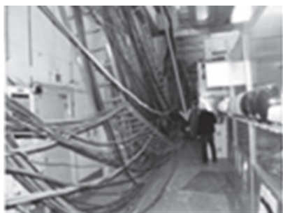
写真1 ケーブルラックの落下
