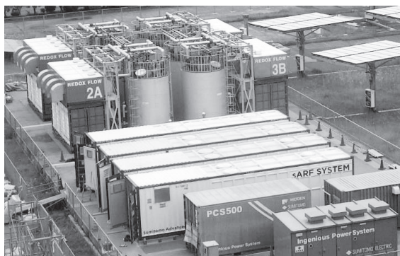
写真1 横浜製作所RF電池
