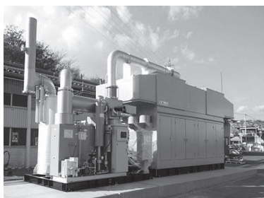
写真1 コージェネレーションシステム
