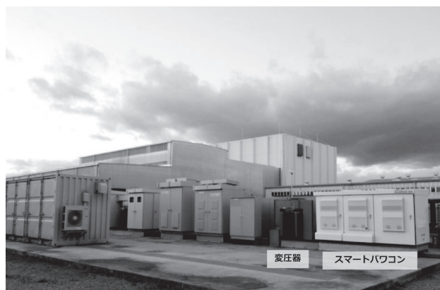
写真2 フィールド実証設備外観
