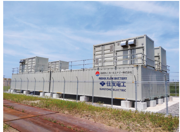
写真1 RF 電池システム外観
