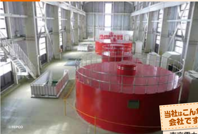
建物内部の発電機
