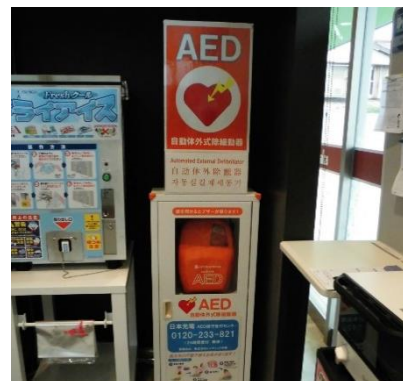
店舗内に AED を設置
