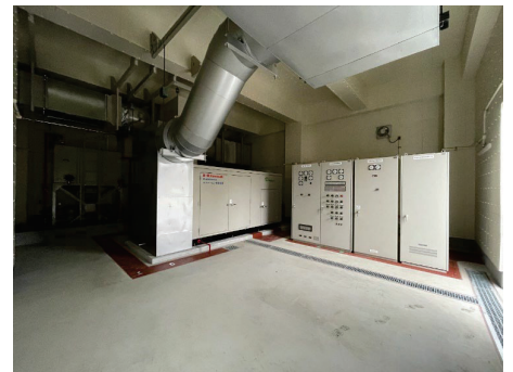
関城浄水場自家発電設備(茨城県企業局)
