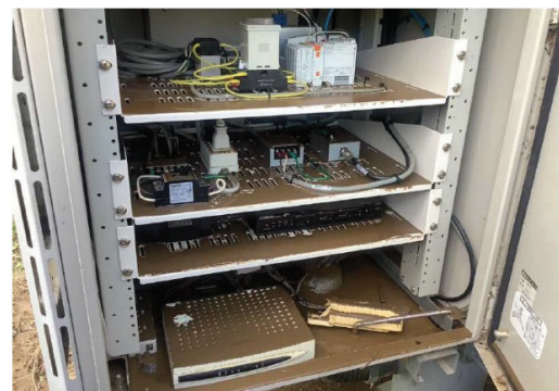
取水設備制御操作盤損壊
