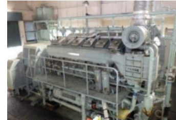
【停電対策の例：自家発電機】
