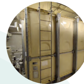
設備の老朽化
