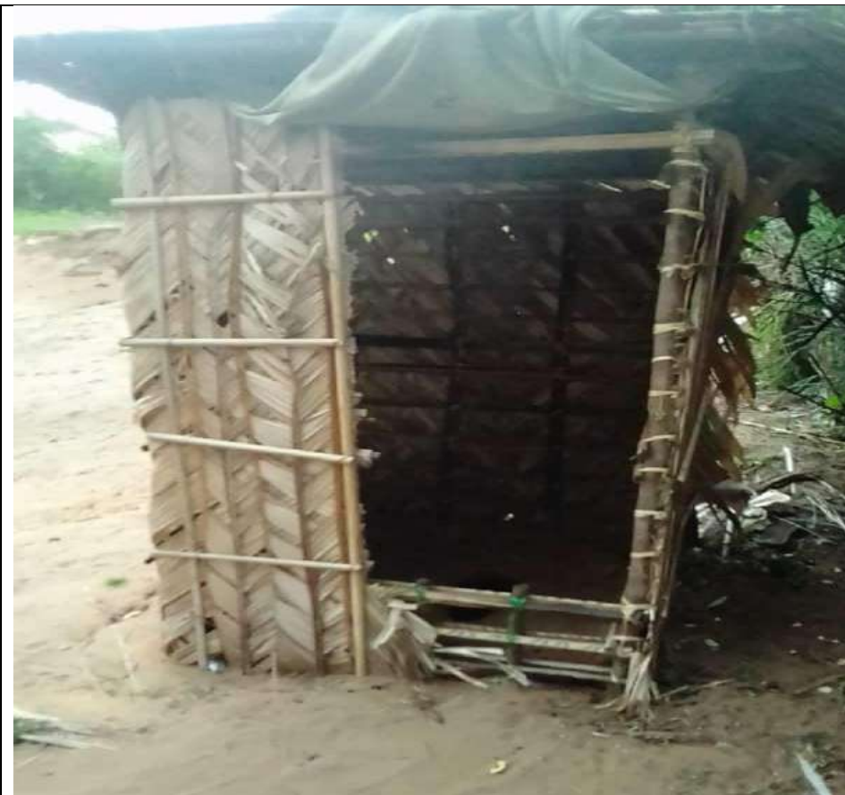
Latrine hygiénique avec superstructure en matériaux locaux à Congo province du Kwango
