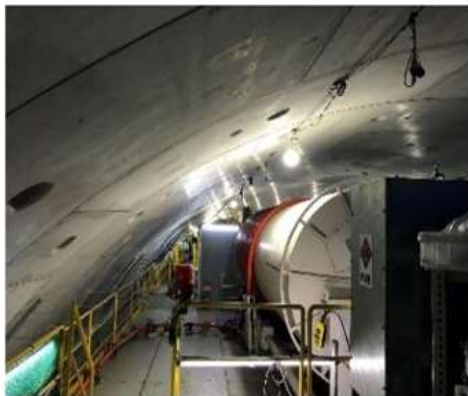
写真4 坑内状況写真(空洞発見箇所付近左側)
