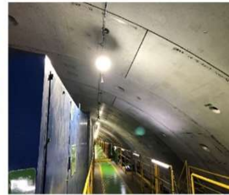
写真3 坑内状況写真(空洞発見箇所付近右側)
