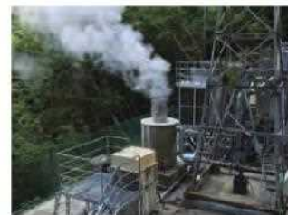
下田温泉バイナリー発電所
