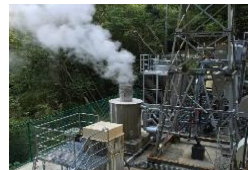
下田温泉バイナリー発電所
