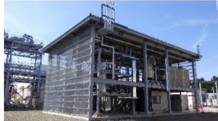
メタネーション試験設備
