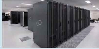
統計科学スーパーコンピュータシステム
