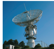
勝浦第1可搬局用パラボラアンテナ
