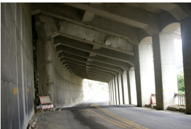
写真-3.2 龍頭トンネル内部（崩壊現場方向を見て撮影）
