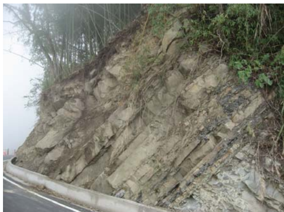
写真 2-6 R18-71km 地点の流れ盤状況 (砂岩と頁岩の互層)
