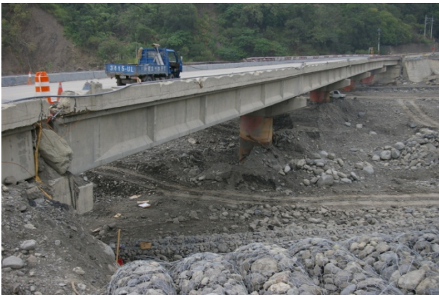
写真-3.32 寶来第二橋の損傷状況
