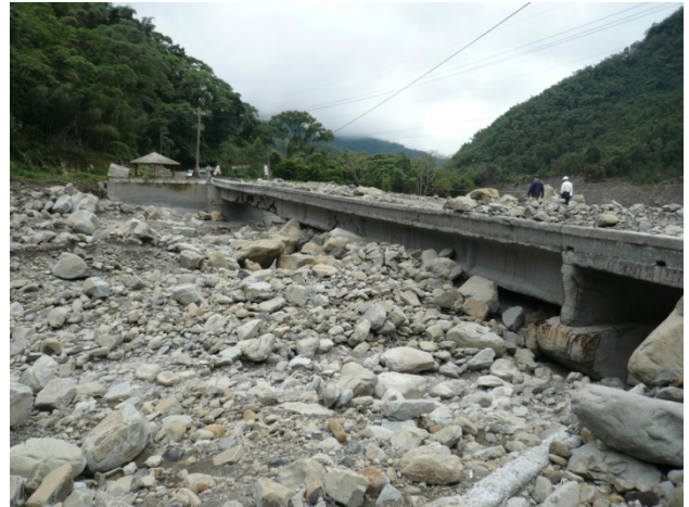
写真-3.8 巴沙娜橋の被害状況
