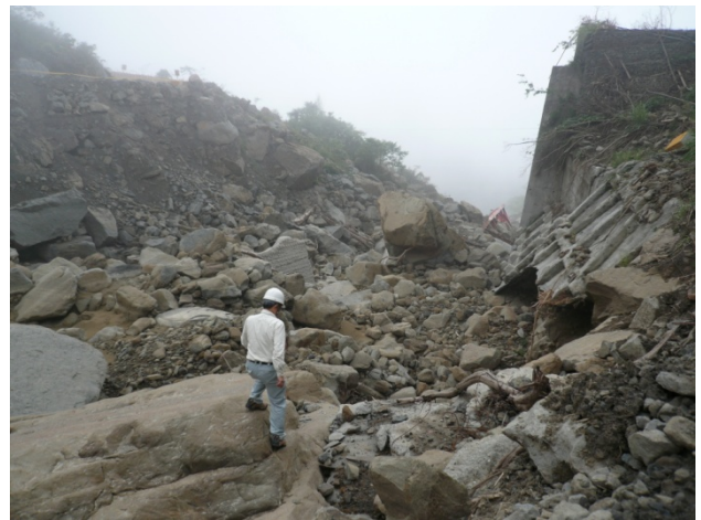
写真-3.14 橋の落橋と擁壁の損傷
