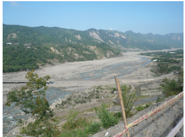
写真-3.35 甲仙四徳大橋の被災状況
