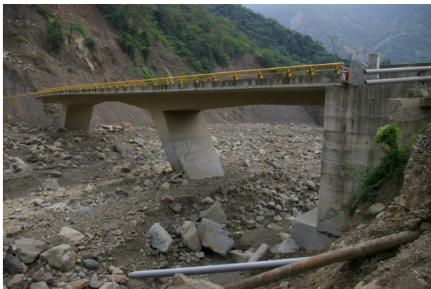
写真-3.28 翠谷橋の被災状況（下流側向きに撮影）
