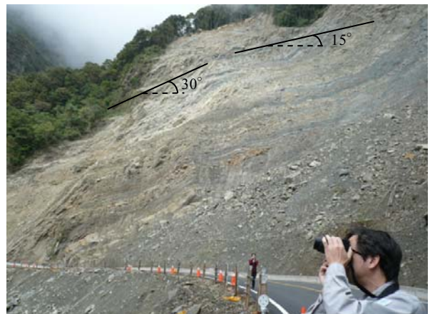
写真-3.4 台湾18号線71km地点の斜面崩壊
