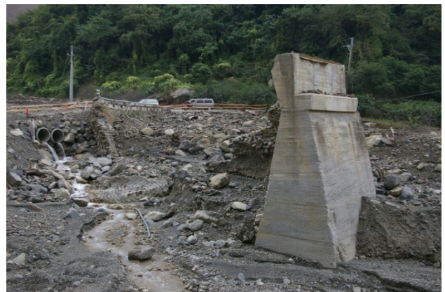
写真-3.29 緑茂地域で損傷した橋
