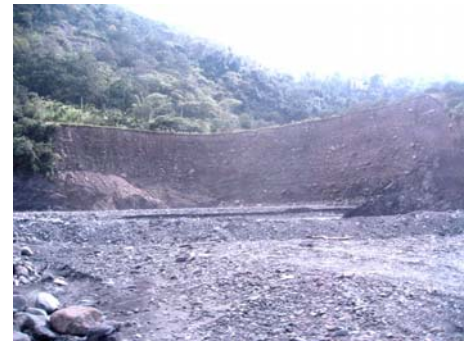
写真 2-12 左岸浸食状況
