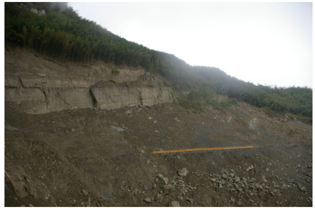
写真-3.3 龍頭坪の斜面崩壊部
