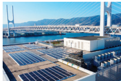
神戸工場の屋上に設置した太陽光パネル
