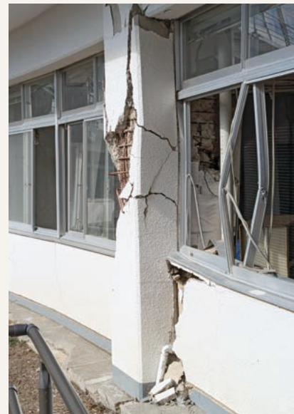
震災後の旧東海大学の外壁
