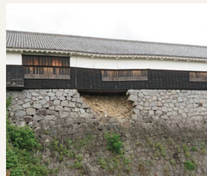
熊本城の崩れた石垣
