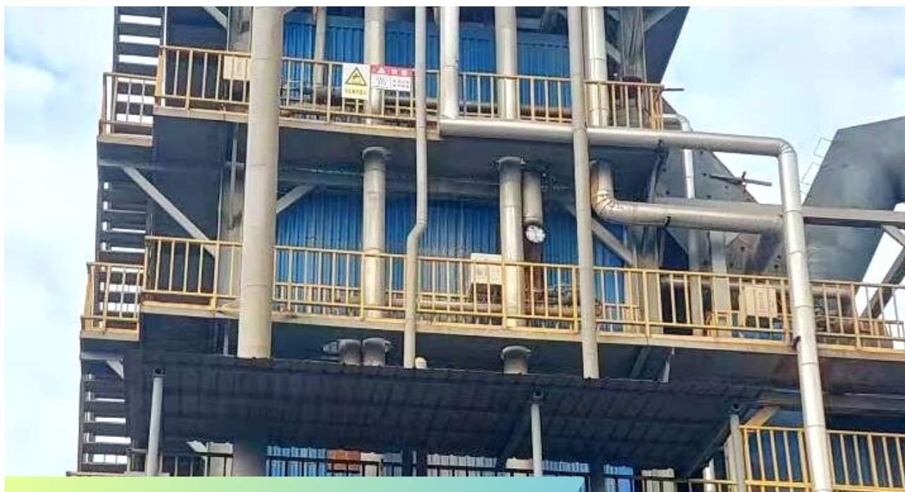
余热蒸汽锅炉
