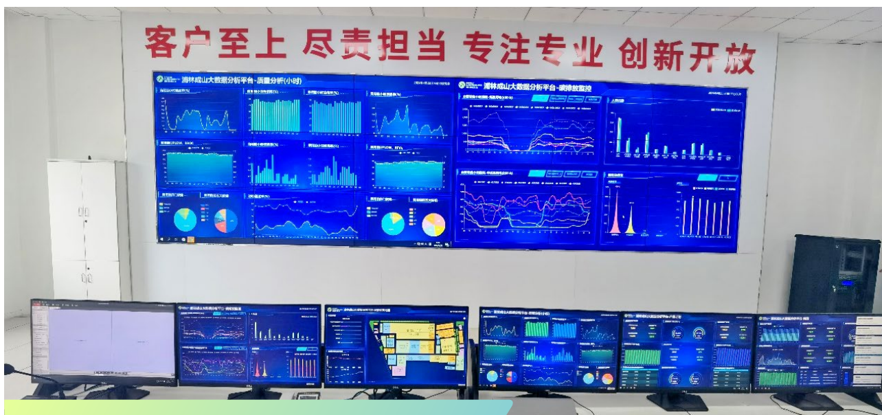
能源管控中心
