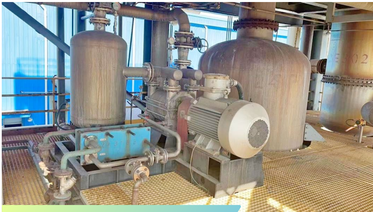
淡盐水真空脱氯系统
