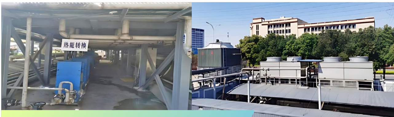
高低温水分流、热能转换项目
