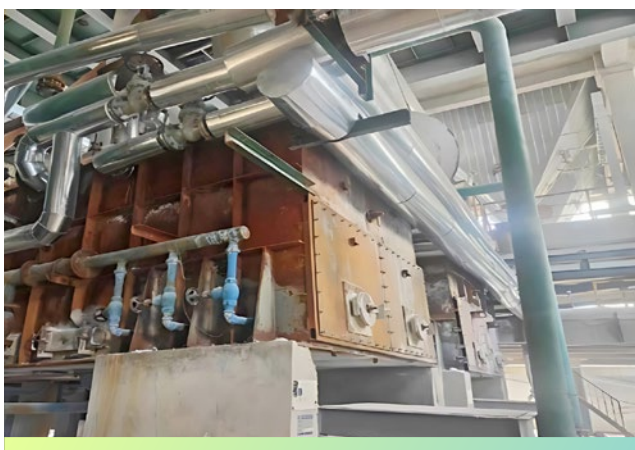
焙烧炉余热 - 流化床换热
