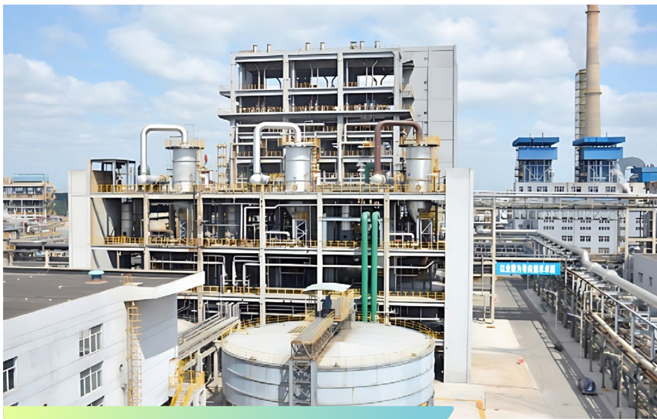
合成氨水煤浆气化装置
