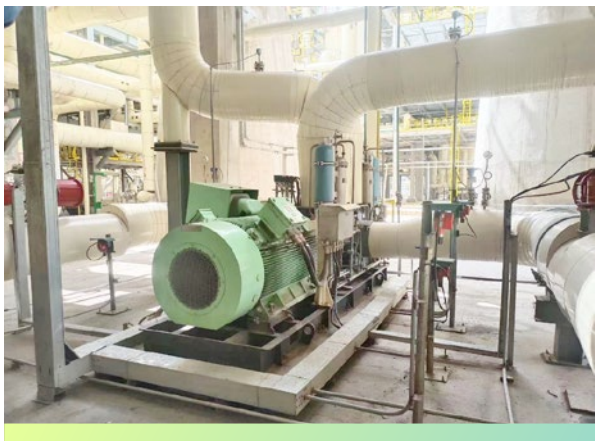
低温甲醇洗液力透平发电系统
