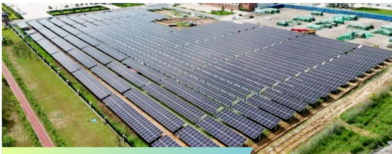
光伏发电系统
