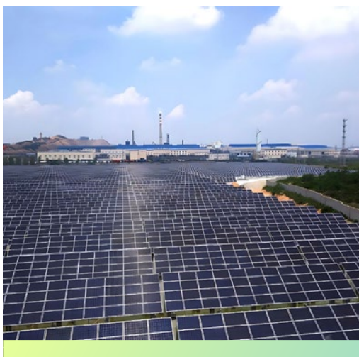
光伏发电系统
