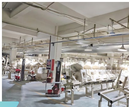
车间余热风管
