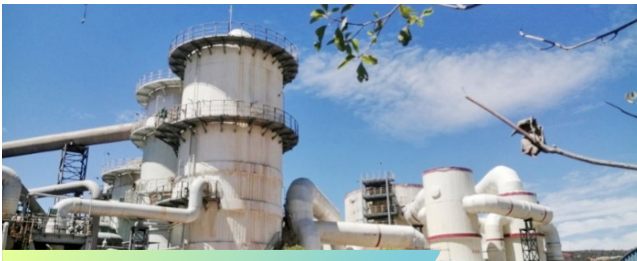
余热回收装置
