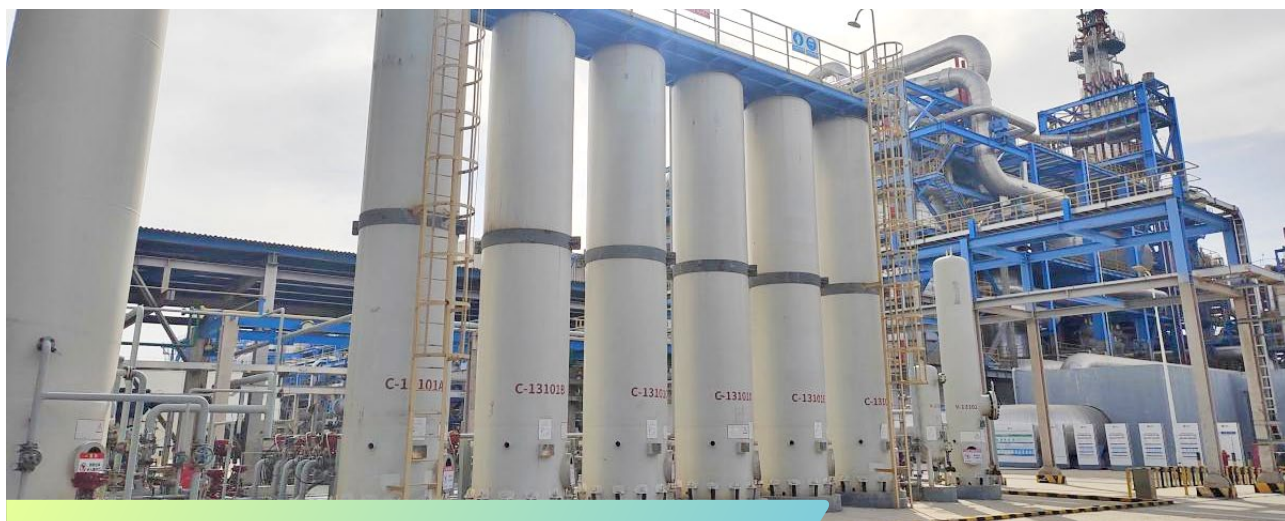
装置变压吸附提纯系统
