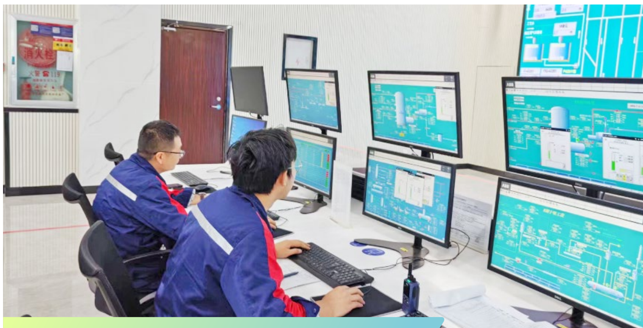
APC 操作现场
