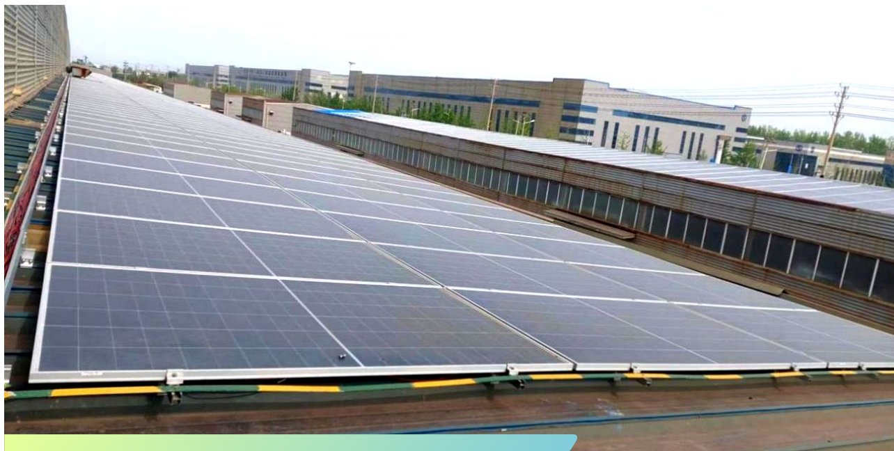
厂房屋顶分布式光伏发电
