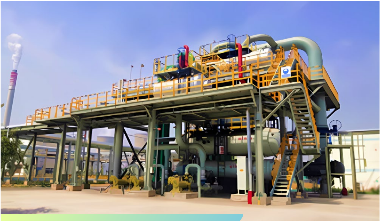
有机朗肯循环余热发电装置
