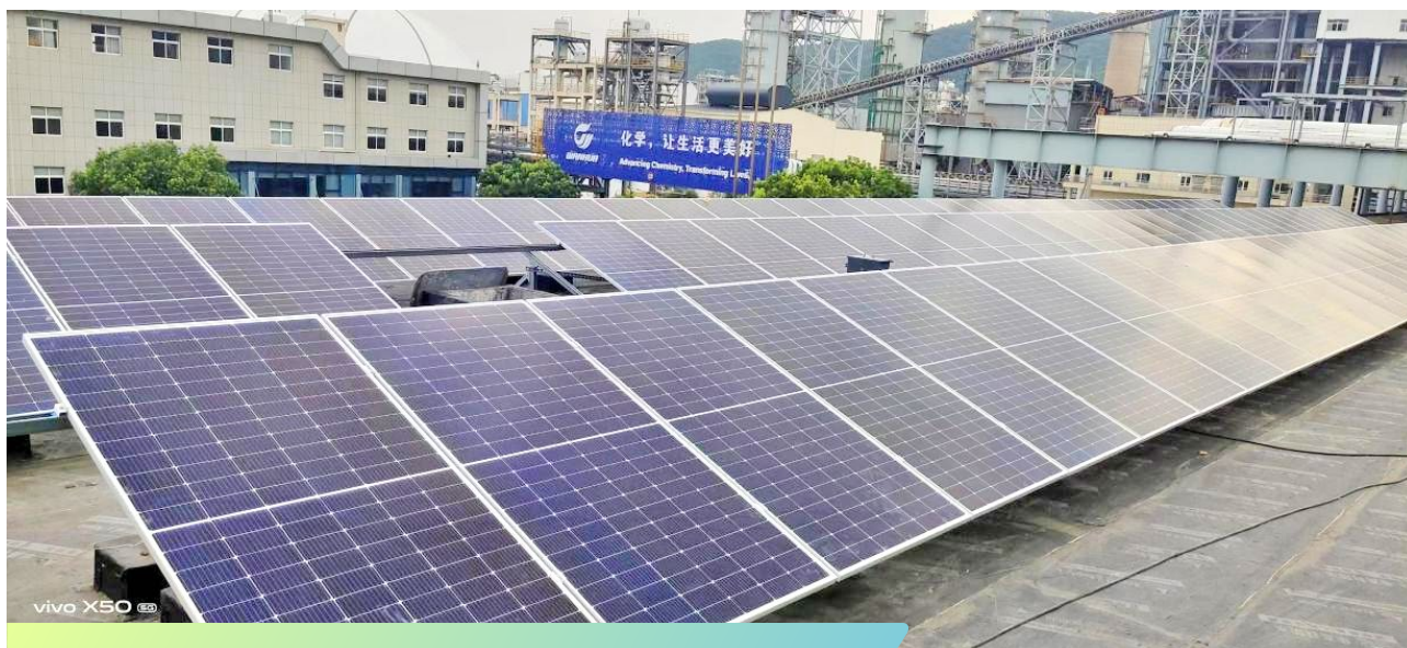
屋顶光伏发电
