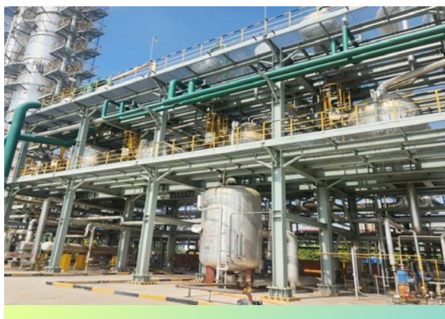
高温冷凝液余热回收利用
