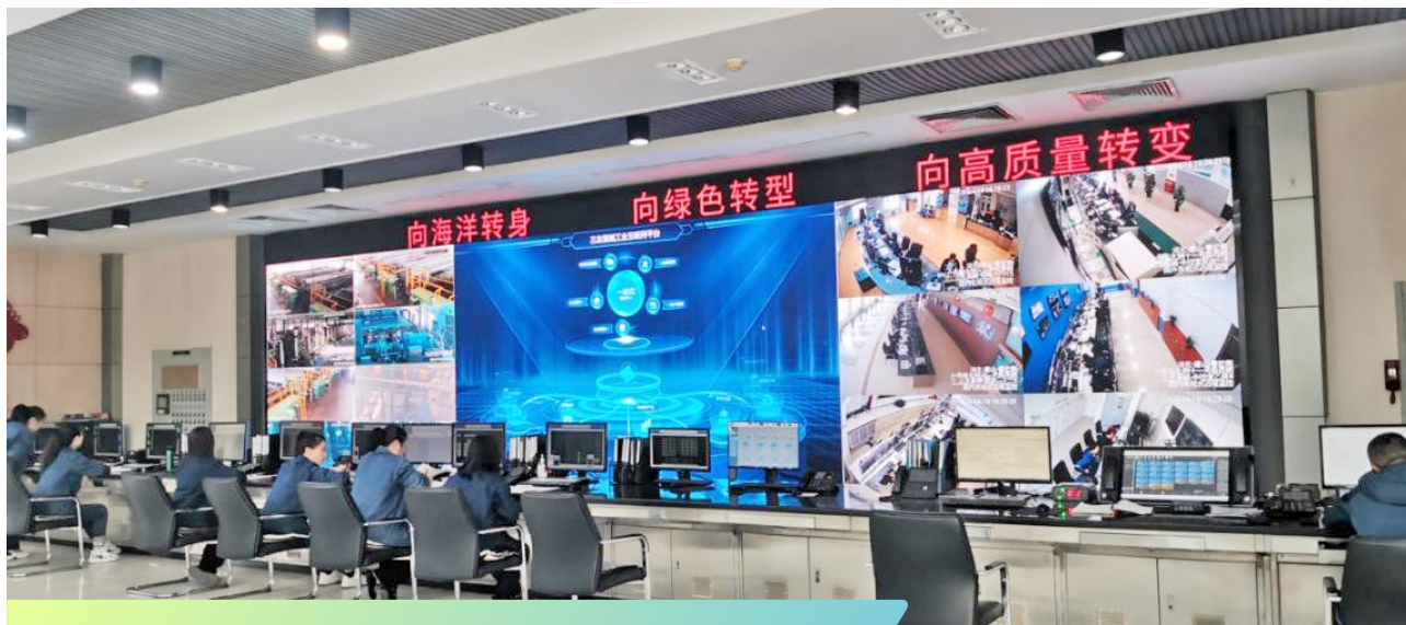
能耗在线监测系统
