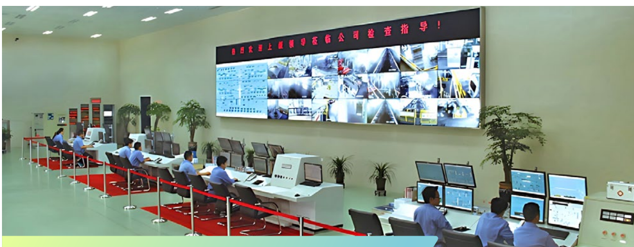
合成氨中央控制室
