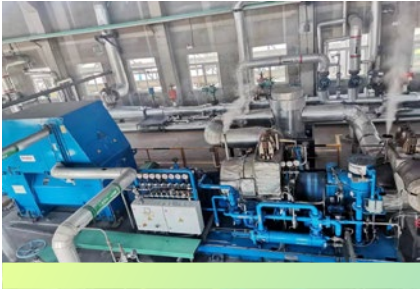
余热发电设施
