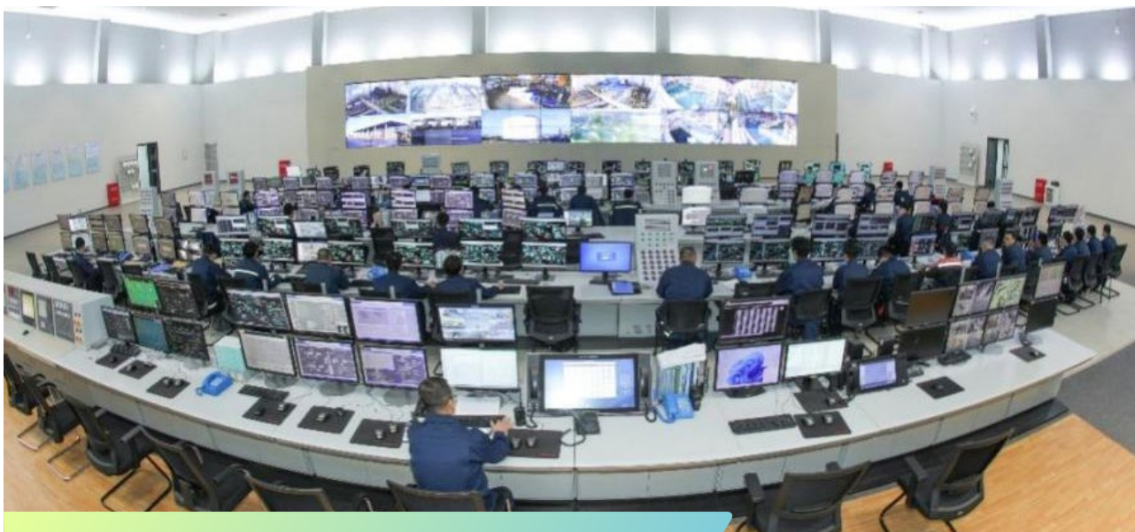
能源管控中心
