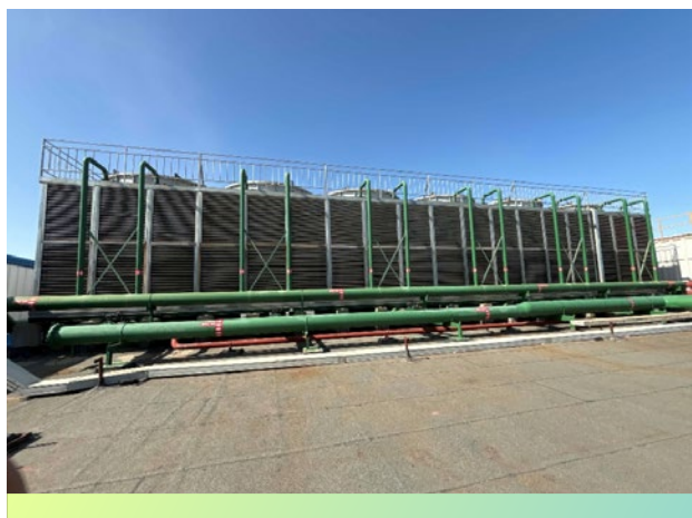
设备冷却水冷却塔
