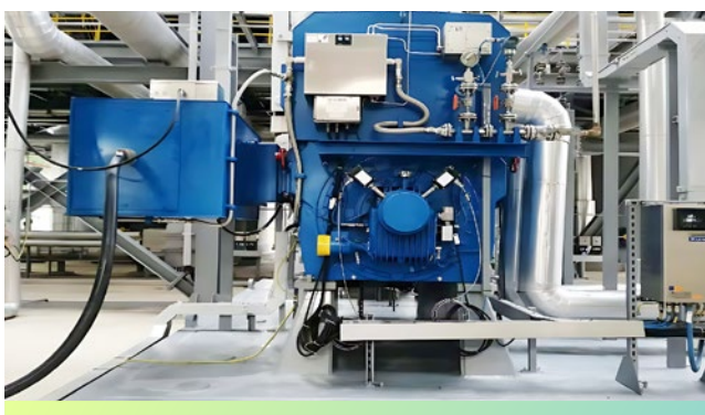
吸附塔循环泵电机（2400 千瓦）
