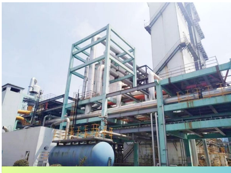
三期航天炉空分装置
