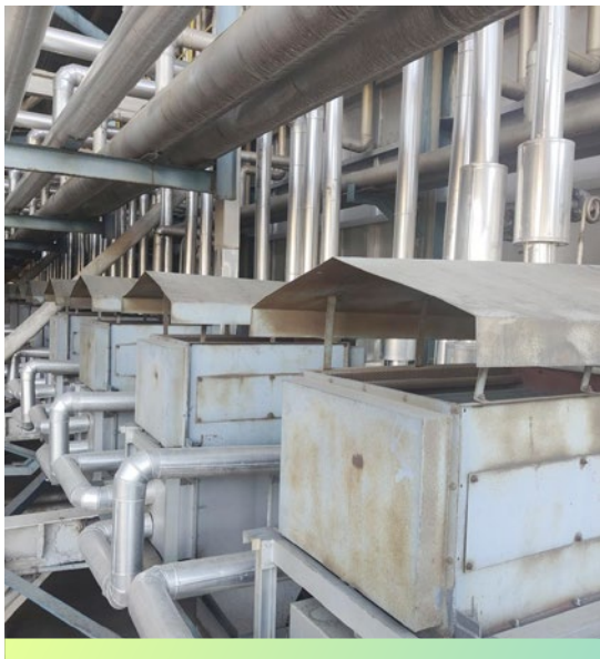
1号乙烯裂解炉空预器
