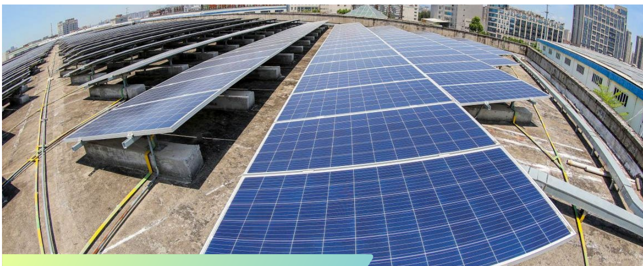
屋顶分布式光伏发电系统
