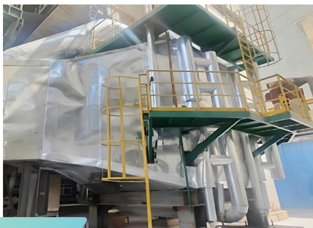
焙烧炉余热 - 烟气换热
