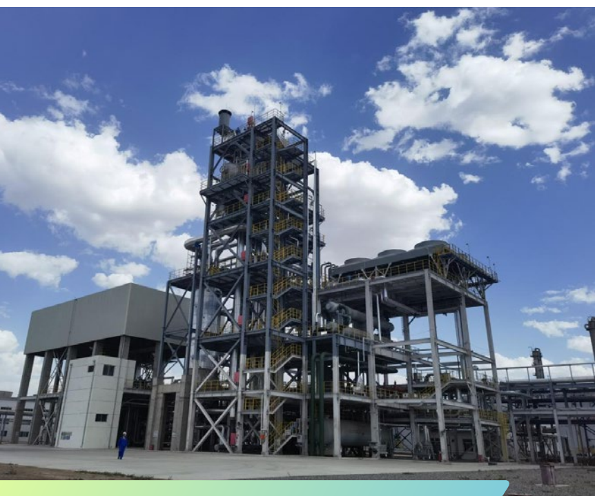
甲醇消除瓶颈改造项目
