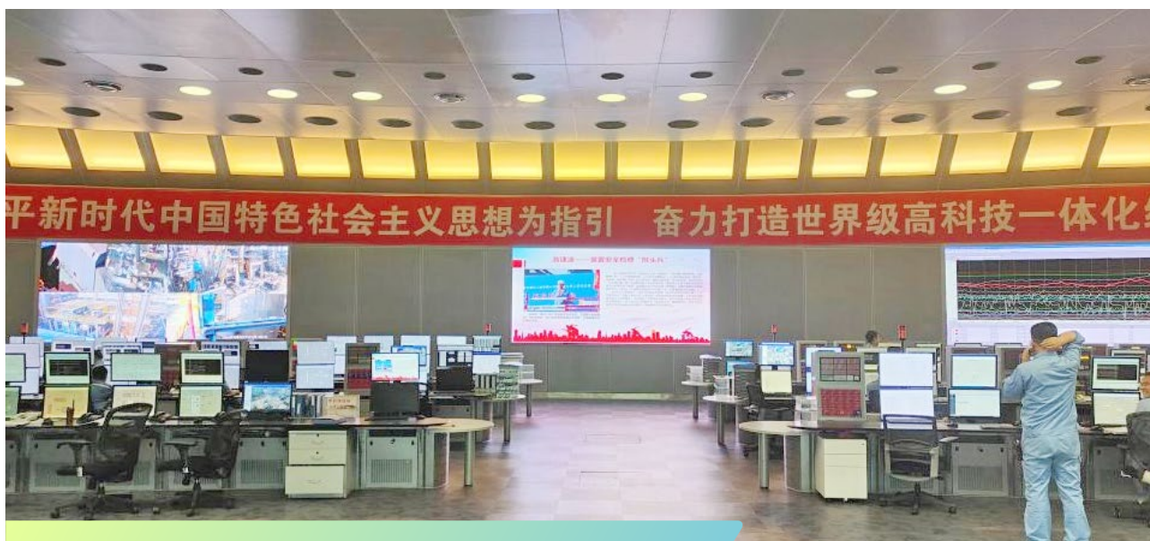
1 号乙烯中控室
