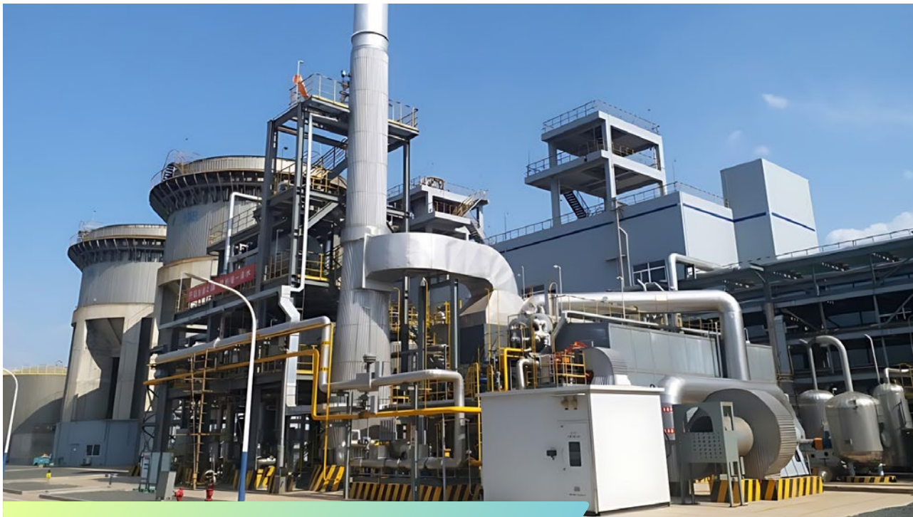
50t/h 氢气锅炉
