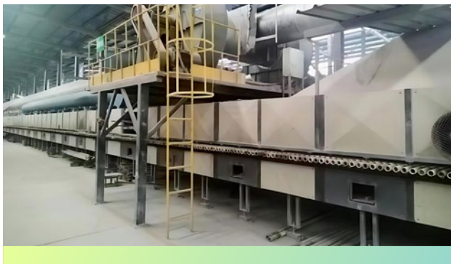
余热烟气管道
