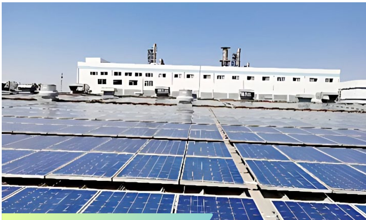
光伏发电系统
