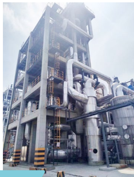
等温变换装置
