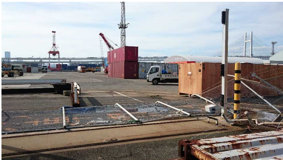
SOLASフェンス倒壊
