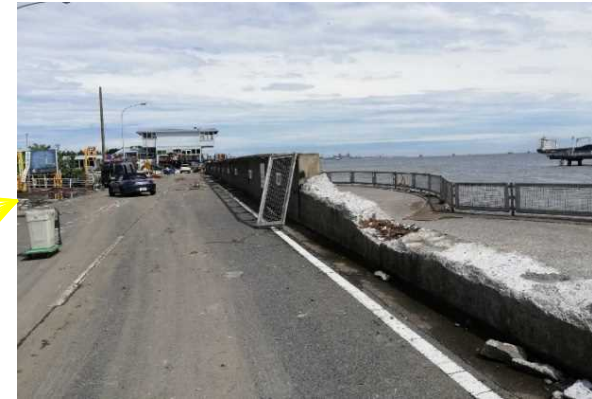
護岸の被災状況(14カ所のべ230m)
