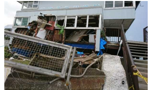
管理棟の被災状況
