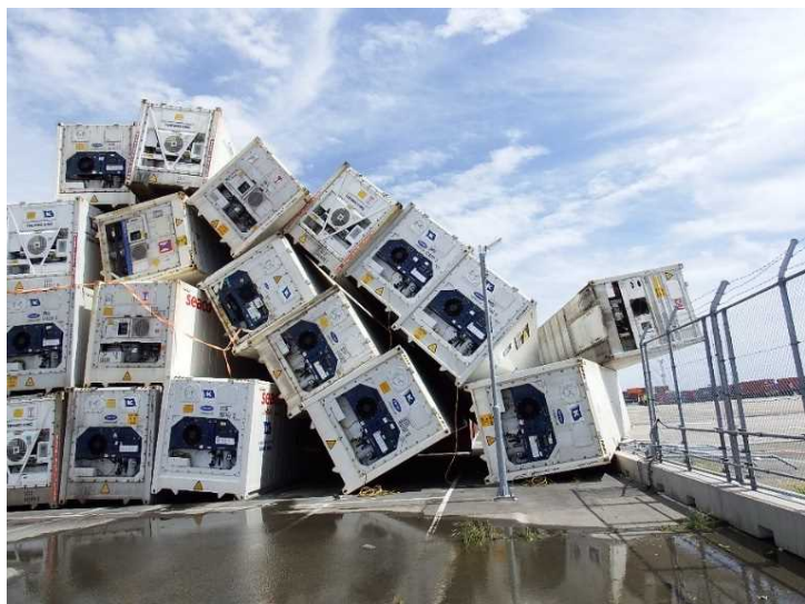
D1 空コンテナ、SOLASフェンス倒壊
