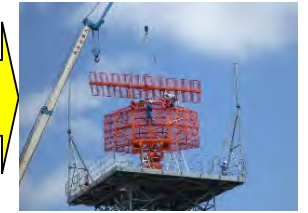
(老朽化した空港監視レーダーの更新)
