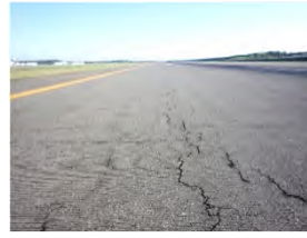
(舗装のひび割れが発生)
