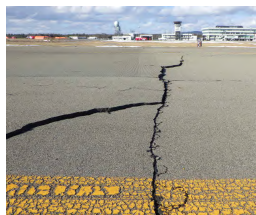
滑走路の亀裂
