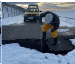
場周道路の陥没
