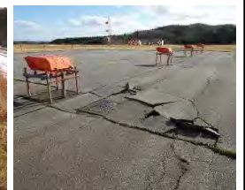
航空灯火の破損
