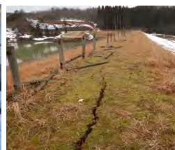
調節池の亀裂
