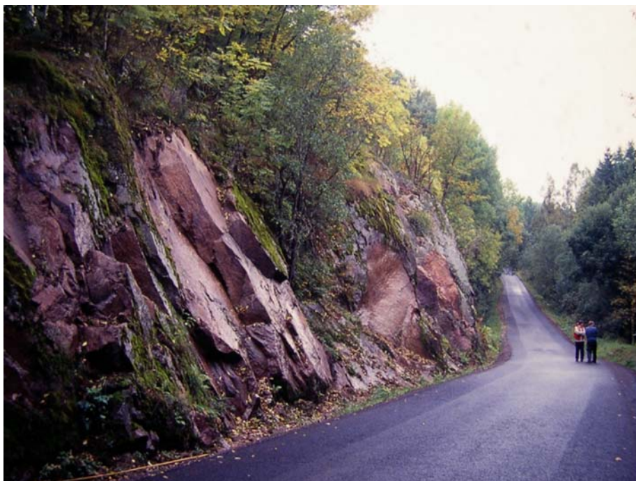
Figur 3 Tett, steil oppsprekning langs vegskjæring.
