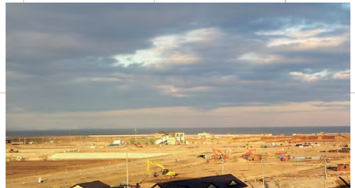
町役場からみた駅周辺地域。中央が建設中のJR新地駅。周辺は造成中(2016年1月26日撮影)
