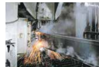
スマートビーム(溶接軽量H形鋼)の溶接 Welding Procedure of Smart BEAM (Welded H-Shapes)
