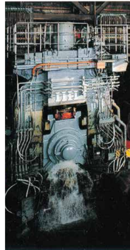
熱延仕上げ圧延機 Hot Strip Mill
