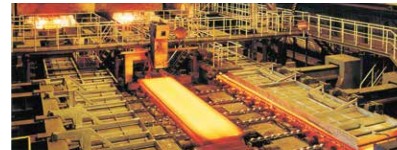
第3連続 casting 設備 No.3 Continuous Casting Machine
