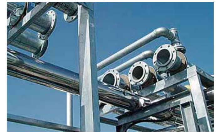
フレア加工ガス配管 Flared Gas Pipe Line
