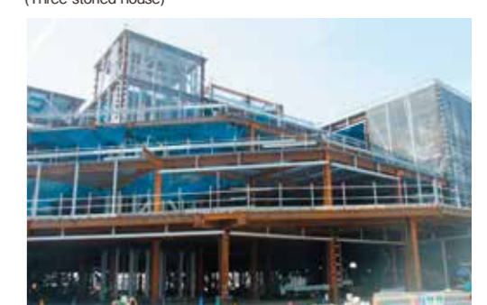
H形鋼の使用例(湘南C-X内のショッピングセンター) An example of using Rolled H Sections: (Shopping Center in ShonanC-X)
