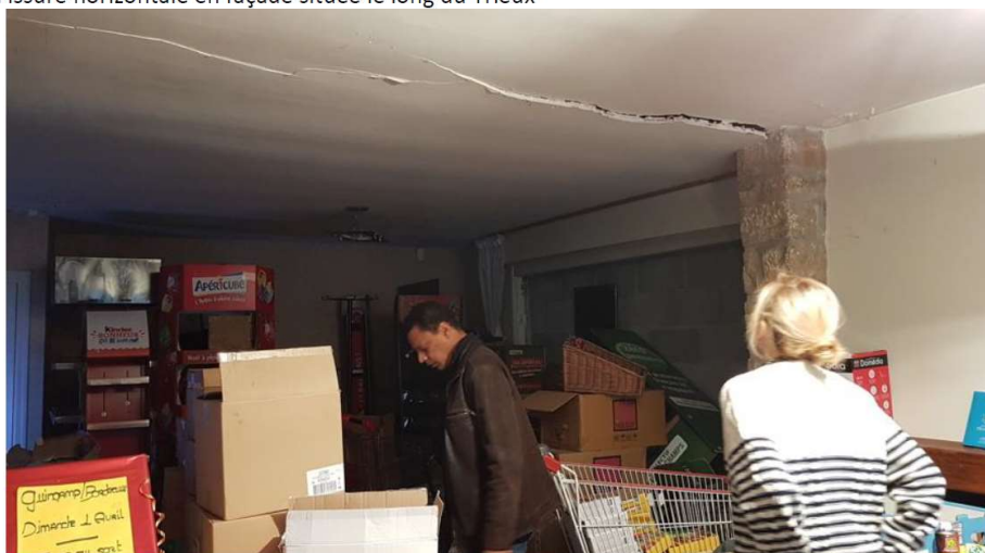
Affaissement du plafond plaques de plâtre dans l'ancien logement de fonction attenant à la grande surface
