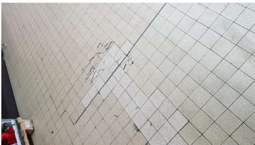
Faïençage du carrelage
