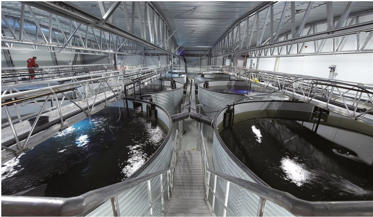
Resirkuleringsteknologi brukes i lukkede anlegg på land. Foto: AKVA group
