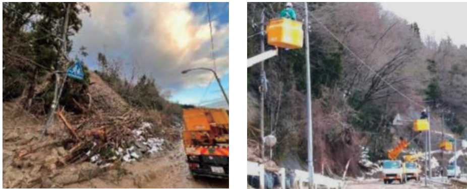
図表 I-1-2-5 通信インフラ（携帯電話）の被害（光ファイバの被害・張替）
