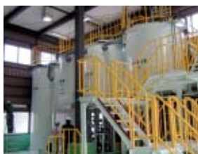
導入したフッ酸処理設備
